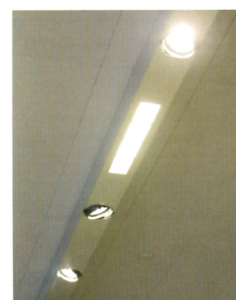
Luminaria Múltiplex (Planta baja)
