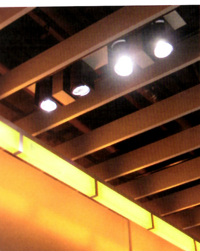
Luminarias 450Only y Multiplex (Planta sotano)
